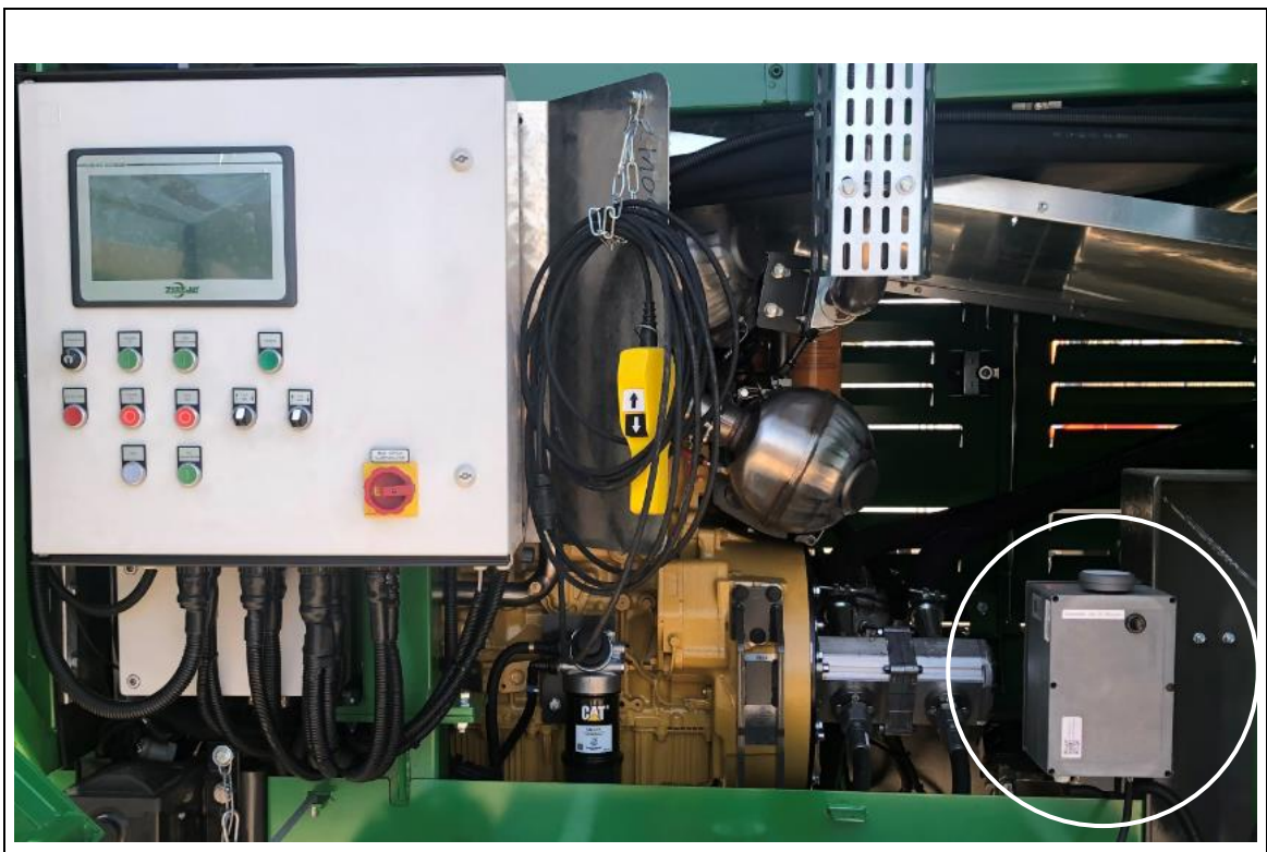
Abb. 11-7: Steuereinheit Wendelüfter neben dem Schaltschrank positioniert
