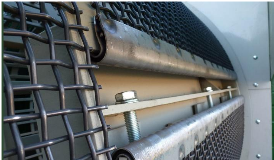
83. ábra: Befogóelemek és csavarozás a befogóállomás felett
