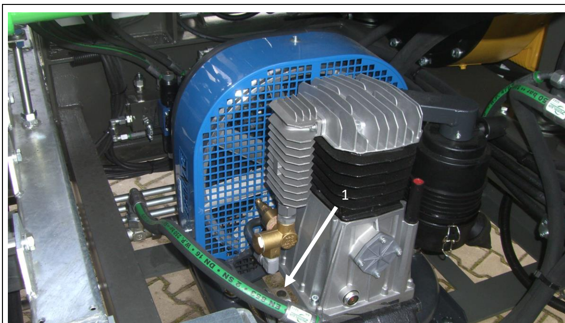
Fig. 11-8: Kompressor i motorrummet
