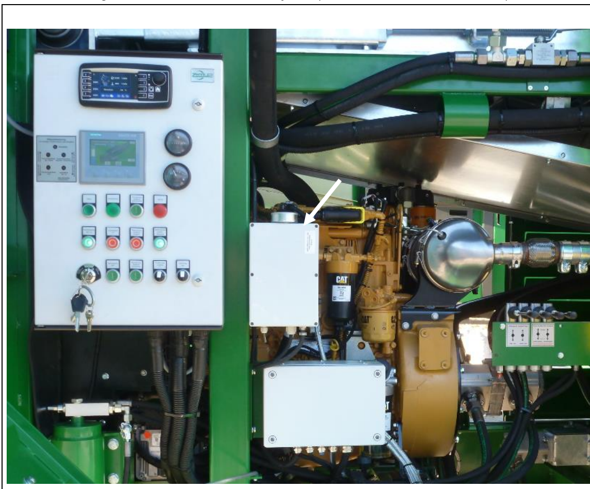
Afb. 11-7: E-Box omkeerbare ventilator naast de schakelkast
