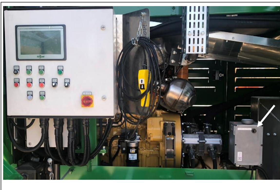
Fig. 117: Den vendbare ventilators styreenhed er placeret ved siden af kontaktskabet
