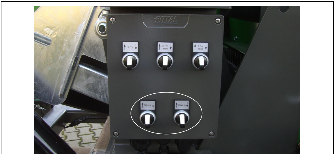
Fig. 73: Kontaktskab med drejekontakt til de Fødebånderste hydrauliske støtteanordninger
