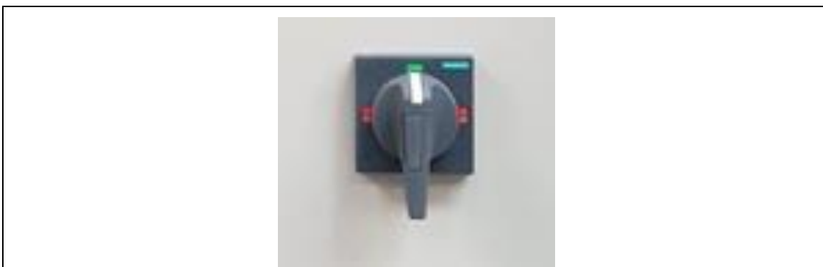
Fig. 4-3: Armario de distribución interruptor selector
