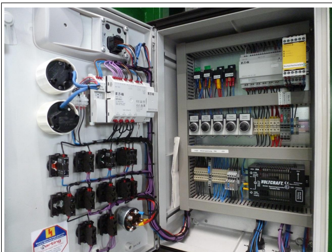
Fig. 8-8 : unité de commande dans l'armoire de commande
