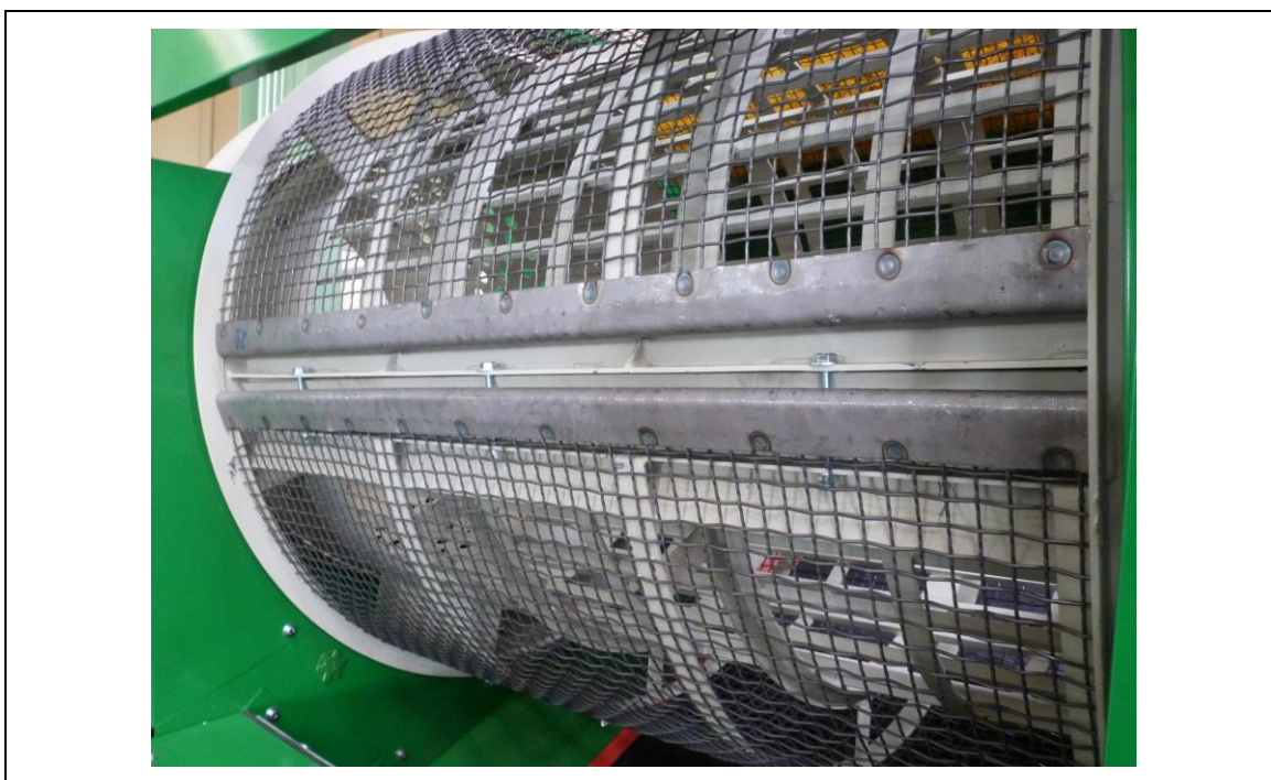
Fig. 11-3 : Station de tension du tamis extérieur
