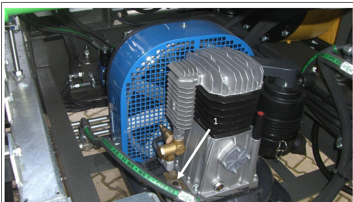
Obr. 11-8: Kompresor v motorovém prostoru
